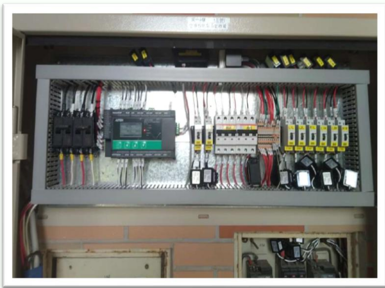
定一樓4樓智慧節能電閘
